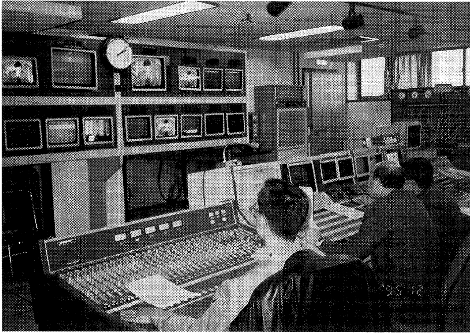
スタジオのサブ・コントロールルーム
