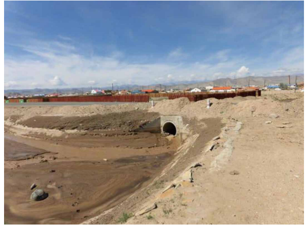
写真8 道路を横切る配管。経が小さすぎ、水があふれた。
